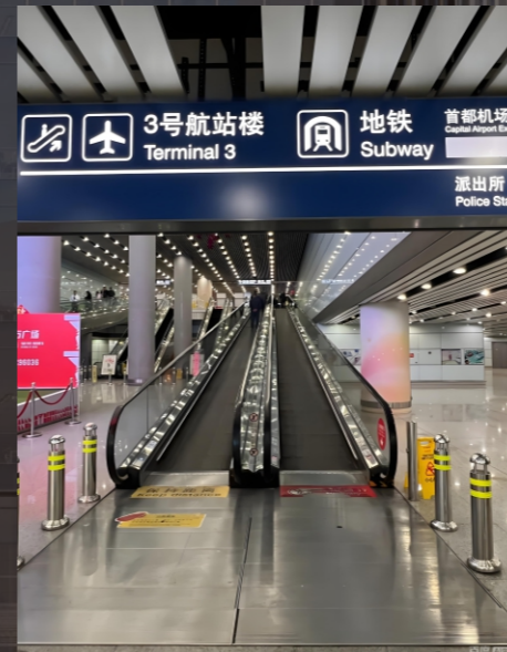
机场手扶电梯
